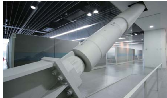
工厂内约配备有570台防震缓冲装置，可吸收地震所产生的冲击
